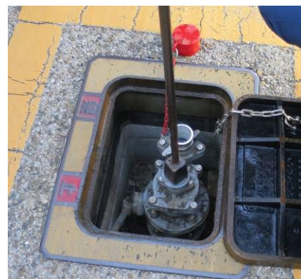
道路上にある消火栓を開けて説明がありました。
