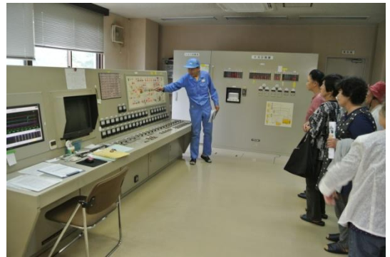
伊賀市浄化センターにて
